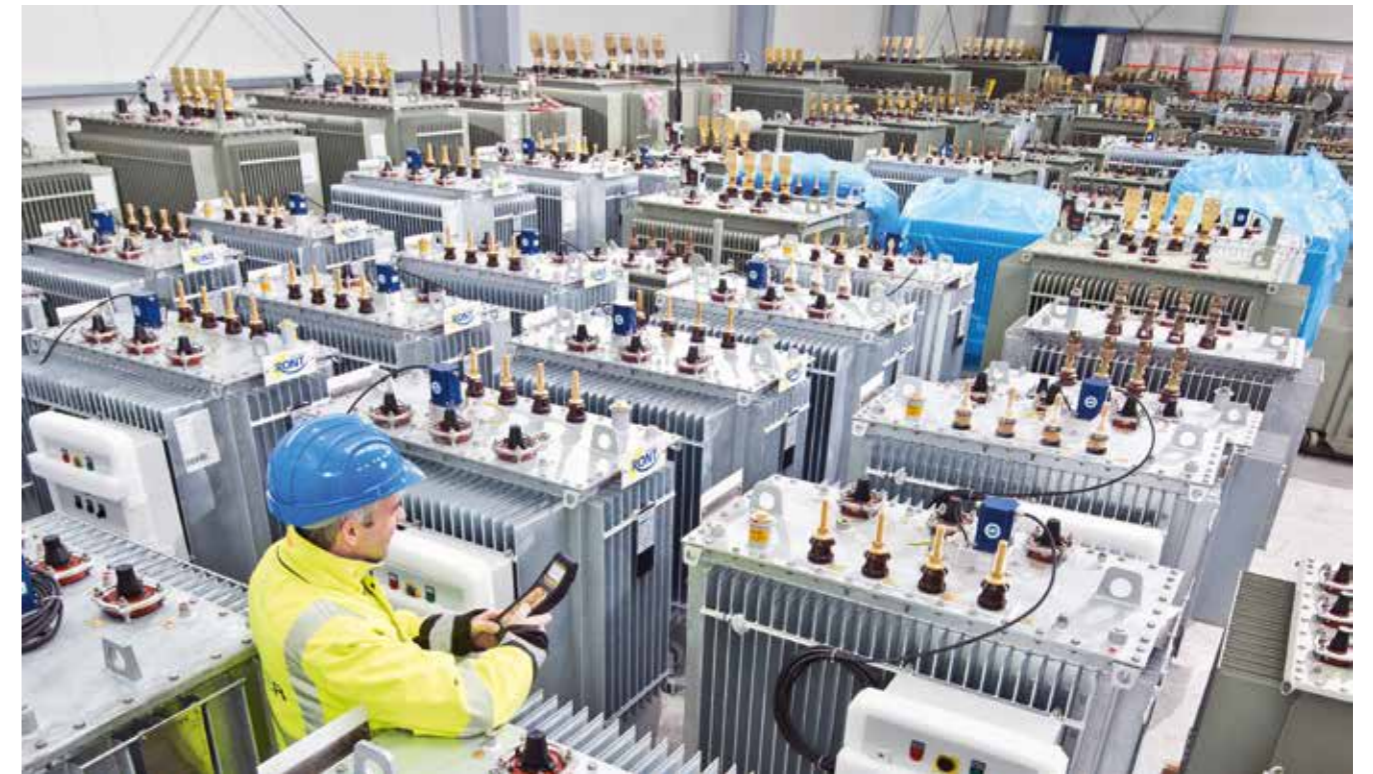
300 Ortsnetztransformatoren für den Netzbetreiber EWE Netz rüstet die Maschinenfabrik Reinhausen mit einem Stufenschalter zur Spannungsregelung aus. © Reinhausen
