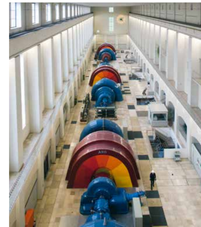
Das beeindruckende Maschinenhaus Reischach der Kraftwerksgruppe Pfreimd mit drei Pumpspeichersätzen.
